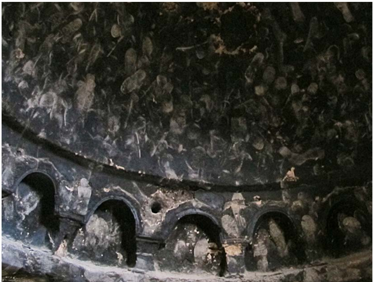
Sanctuaire maculé de noir de fumée et frappé de semelles de chaussures (Fig. 6)
